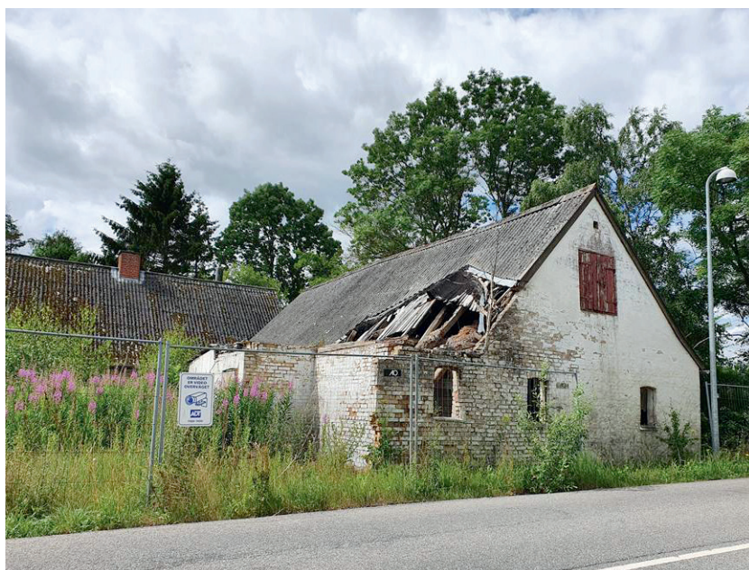
› Faldefærdig gård, som er afskærmet med byggehegn.
